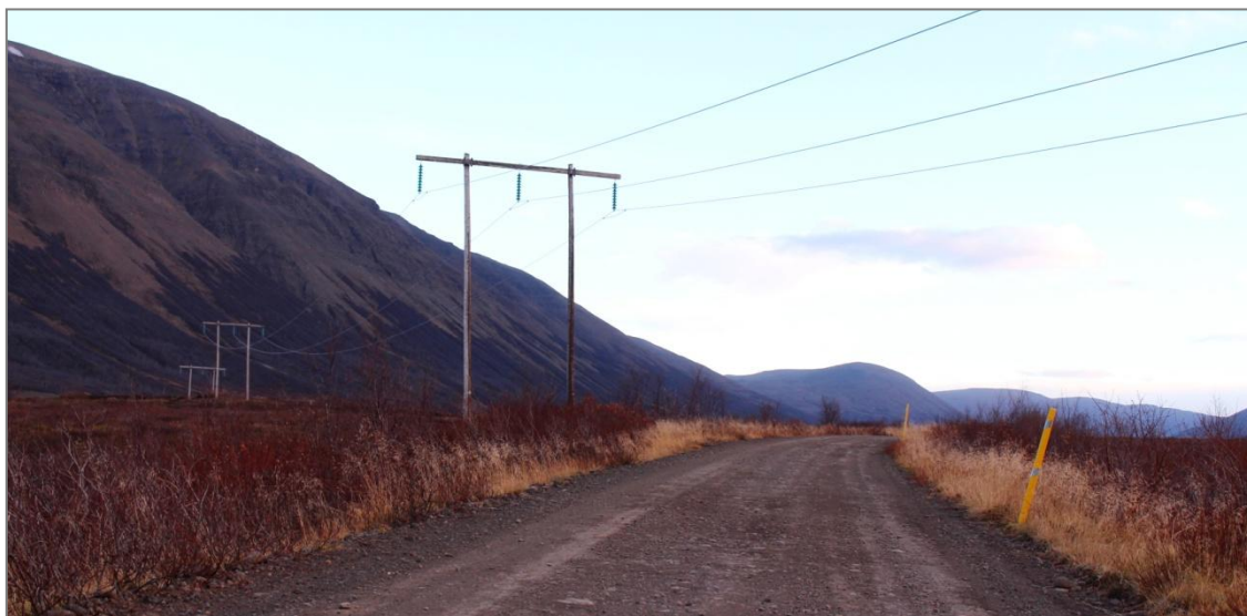
Kröflulína 1 þverar Fnjóskadalsveg (833) í landi Sellands.
